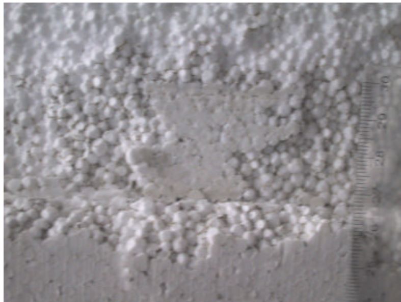
Kuva 11. Lähikuva elementin K2 uran ja sileän kohdan kautta kulkevasta murtopinnasta. Sementtiliimaa on tunkeutunut jopa 10 mm syvyyteen EPS-helmien joukkoon.
